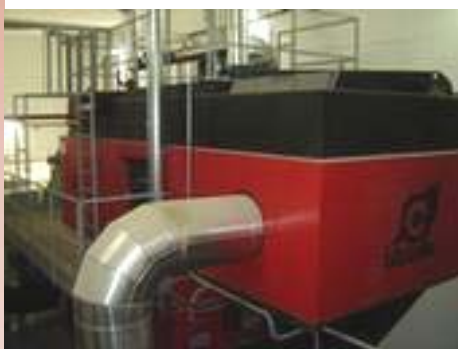
Lons-le-Saunier : chaufferie au bois. © DDT 39. Chantal Berthet-Bondet.
