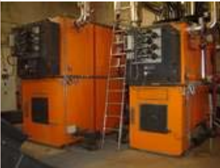
Arinthod : chaufferie au bois.
