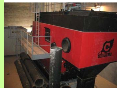
Lons-le-Saunier : Chaufferie au bois. © prêt : ECLA.
