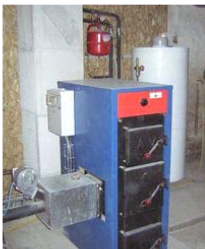
Chaudière à « granulés bois ». © prêt : « JURA Habitat ».
