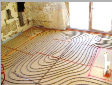
Plancher chauffant. © Prêt : Laurent Boiteux.
