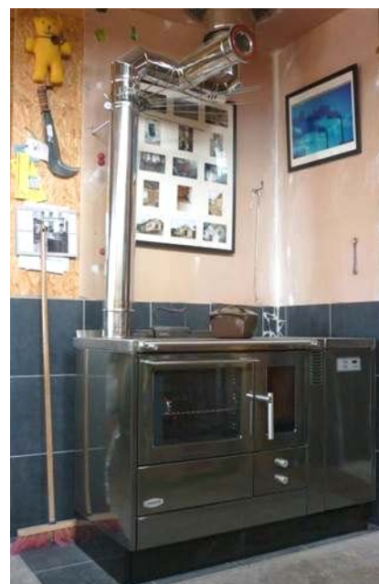
Poêle à bois bouilleur. © Prêt : Laurent Boiteux.
