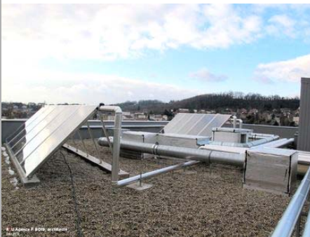
Lons-Le-Saunier. Immeuble BBC : ventilation. © Agence Frédéric Bois.
