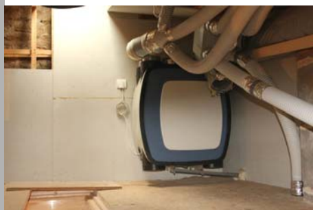
Ventilation Mécanique Contrôlée double flux. © Prêt : CAPEB.
