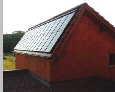
Capteurs solaires thermiques. © Prêt : Laurent Boiteux.
