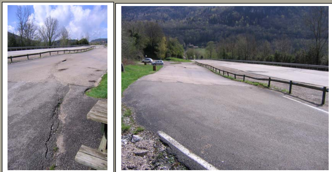
Figure 1 : Affaissement au niveau du belvédère de Buclans (RD 470)
