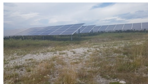
Parc photovoltaïque de Soucia
