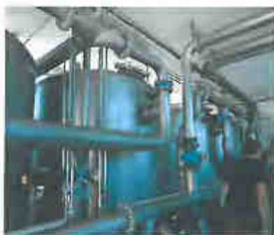
Photo 5 : filtres à sable à la station de traitement
