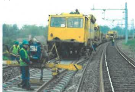
Longs Rails soudés sur traverses béton
