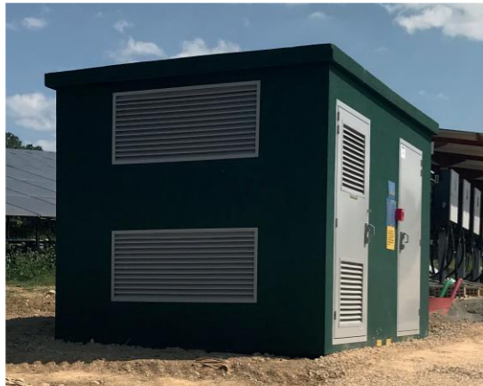
Figure 7 : Poste de transformation
