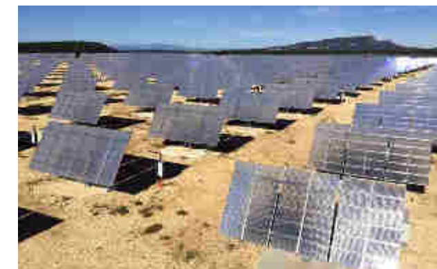
10,7 MWc Parc solaire à concentration et trackers Aigaliers (30) – Foncier communal Développement, Financement, Construction et Exploitation Plus grande centrale à concentration de France
